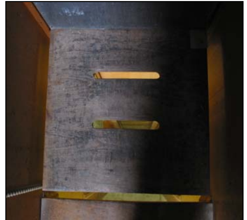
Bild 1: Durch die Seitenöffnungen und die Sichtlöcher in der Plattform kann von unten erkannt werden, ob der Aufzug besetzt ist.
