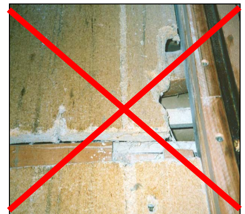
Bild 5: An vorstehenden oder beschädigten Schachtwänden können Körperteile, Schuhe, Kleider oder Material hängen bleiben und mitgerissen oder eingeklemmt werden.
